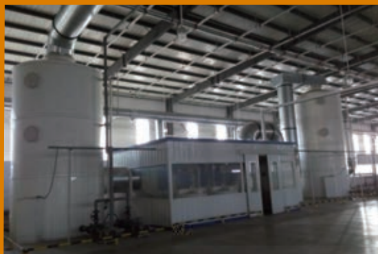
海綿發泡廢氣處理裝置1
