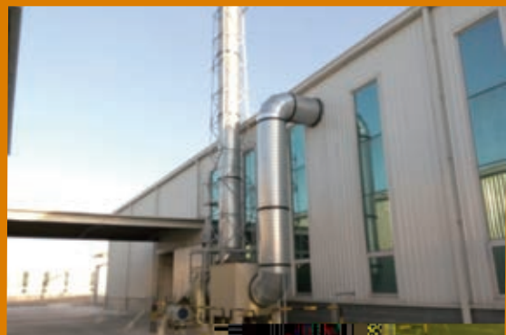
海綿發泡廢氣處理裝置2
