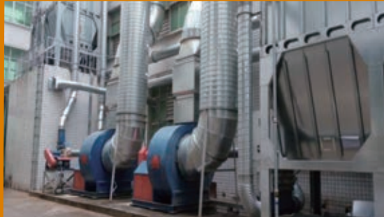
木工車間粉塵處理裝置
